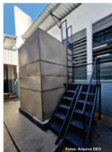
Figura 23: Reservatório águas residuais
