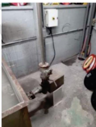
Figura 22: Bomba para drenagem
