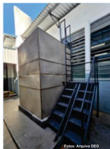
Figura 23: Reservatório águas residuais
